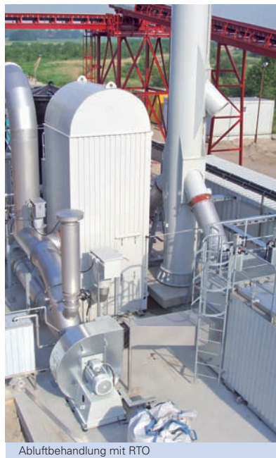
Abluftbehandlung mit RTO
