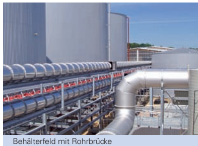
Behälterfeld mit Rohrbrücke
